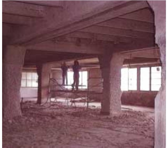
Même lorsque les aciers ont été mis à nu par le feu, la dalle de béton résiste.
