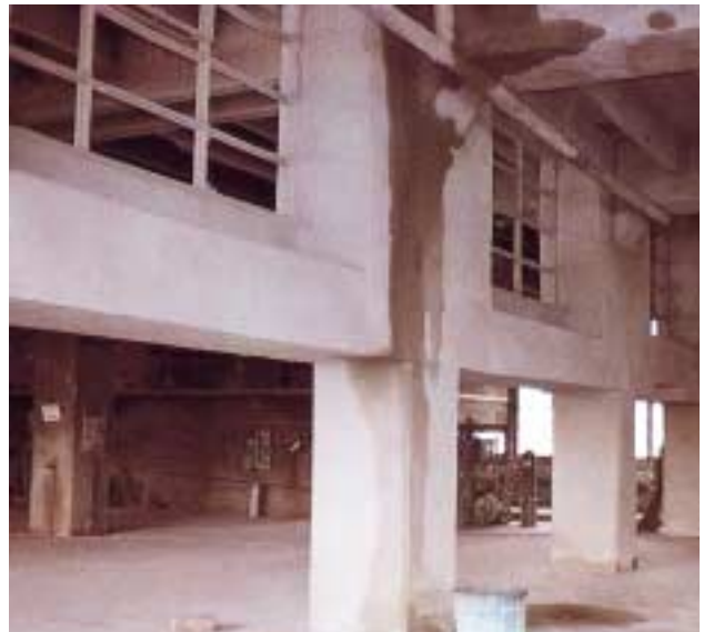
Un bâtiment en béton même fortement endommagé par un incendie peut être rapidement remis en état.
